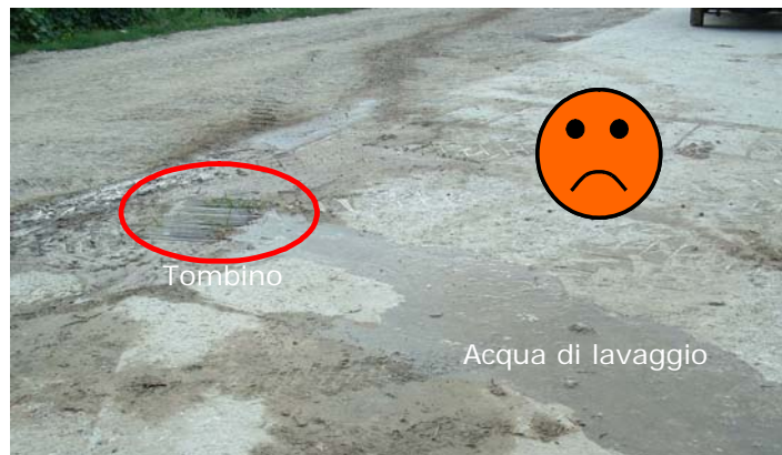
Fig. 64 – Acque di lavaggio immerse direttamente nella rete fognaria
