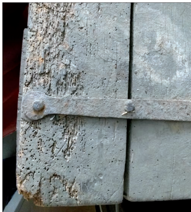
1. Esempio di degrado dovuto all'attacco di insetti xilofagi. (M.P. Longo Cantisano)
