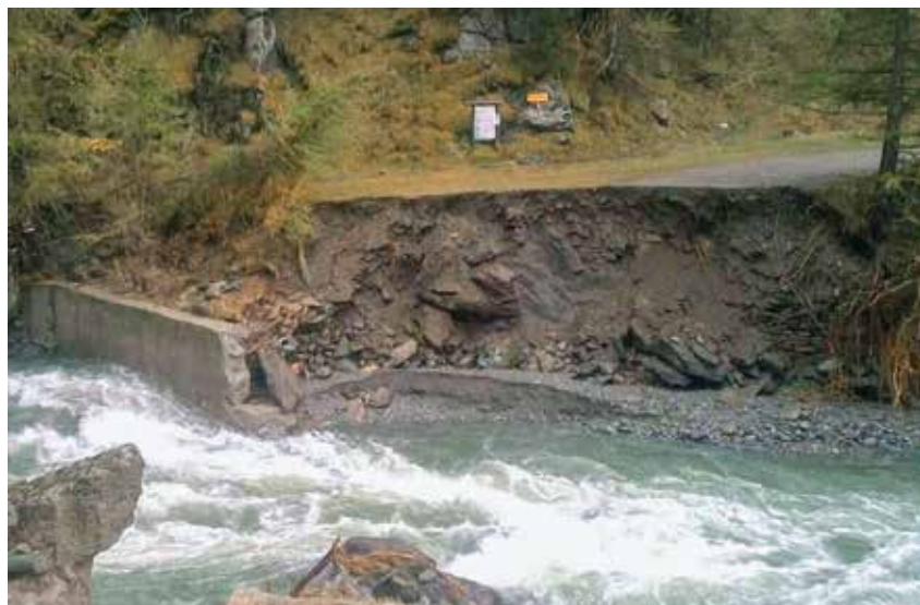
La zona del ponte sul Torrente Urtier di accesso all'alpeggio di Bouc completamente asportato nel Comune di Cogne
