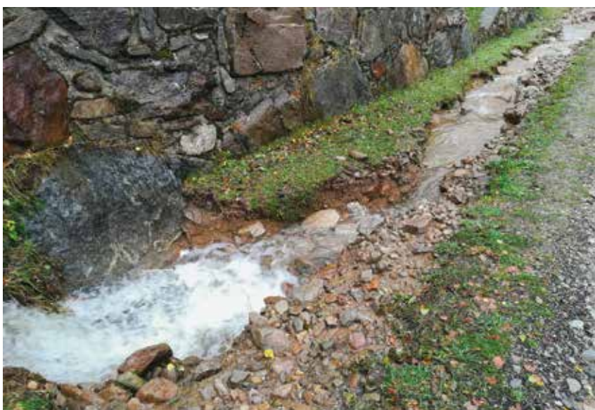
Viabilità in località Pillaz nel Comune di Fontainemore, con erosione concentrata del sedime stradale
