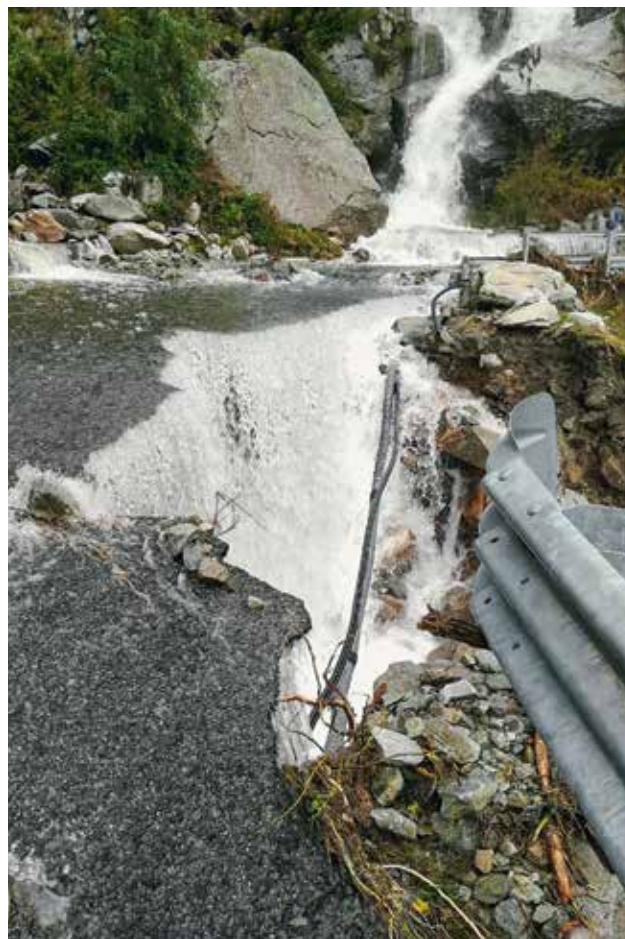
Fuoriuscita del Torrente Varail Frinna sulla strada comunale per il vallone di Niel nel Comune di Gaby
