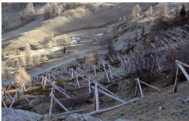
Figura 4.6 Treppiedi in legname a monte di piste da sci (Sauze d'Oulx, Torino).
