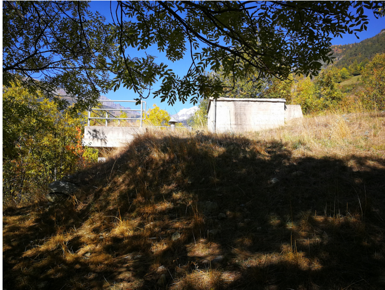
Opera di captazione esistente in parte interrata da ampliare con la realizzazione della centralina idroelettrica
