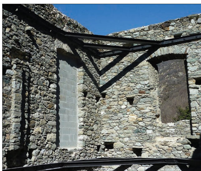
4. Angolo nord-ovest del fabbricato 2, particolare interno dei due livelli di rinforzo strutturale. (C. Avantey)
