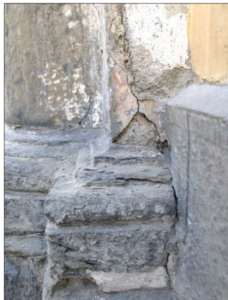
3. Dettaglio del degrado prima del restauro. (C. Béthaz)
