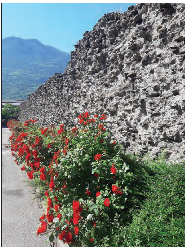
20. Il nucleo del muro a sacco della cinta muraria visibile nella parte meridionale di via Vevey. (M.C. Fazari)
