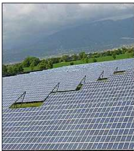
Un campo fotovoltaico
