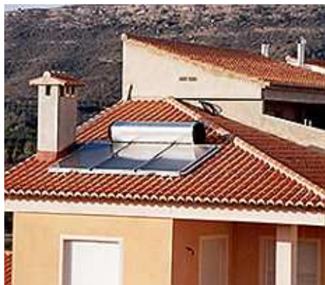
Un impianto solare termico
