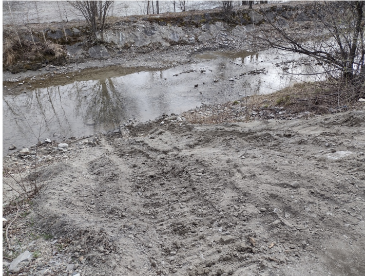
Figura 2.13: Rampa di ingresso in alveo in prossimità del ponte per Plan Felinaz in sinistra idrografica.
